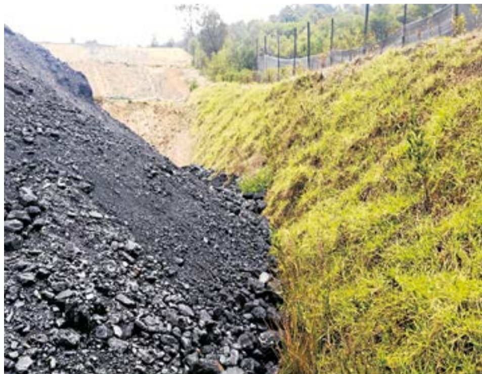
Las inspecciones técnicas evidenciaron afectaciones a una quebrada innominada, dispersión de polvo hacia viviendas cercanas. A.Part
