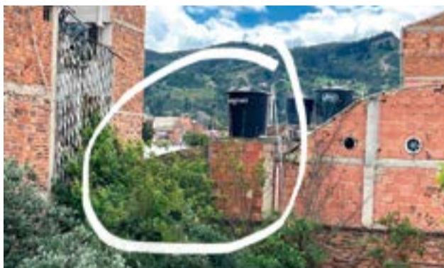
Aquí se observa una de las paredes por donde, de acuerdo a la denuncia, se escapan.
