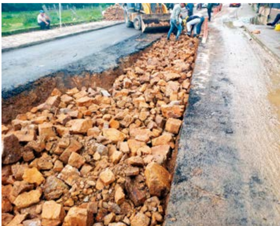
Entre las intervenciones realizadas se encuentra un tramo crítico en la vía al municipio de Carmen de Carupa. Archivo particular.
